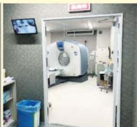
中央市民病院のコンテナ型CT室
